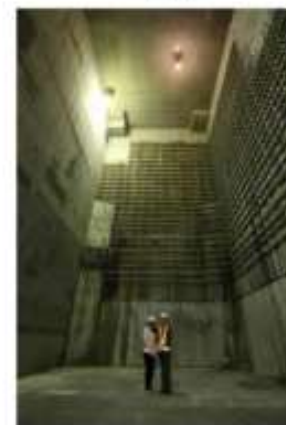
・「大容量蓄熱槽」(高さ16m、水深約16m) このような槽が4槽あり、合計保有水量は約7,000トン(25mプールに標準水量約400トン換算では約17杯分)となります。
