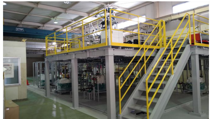
炭素回収及び塩化鉄回収装置（全景）
