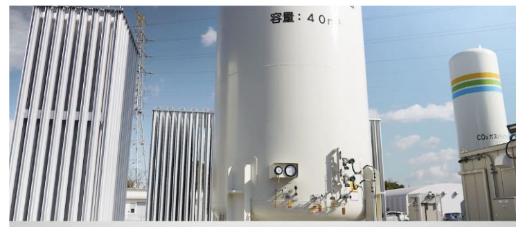
IGCC及びバックアップ（液炭）CO 2 設備
