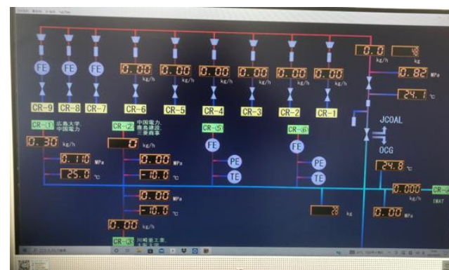
CO 2 遠隔監視モニター
