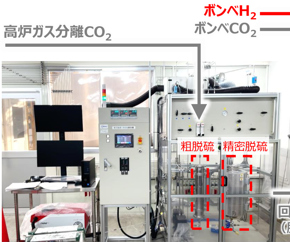
乾式脱硫試験装置 (CO 2 前処理)
