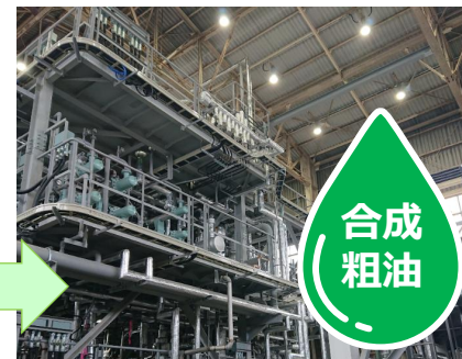
合成原油製造 (FT合成反応設備)
