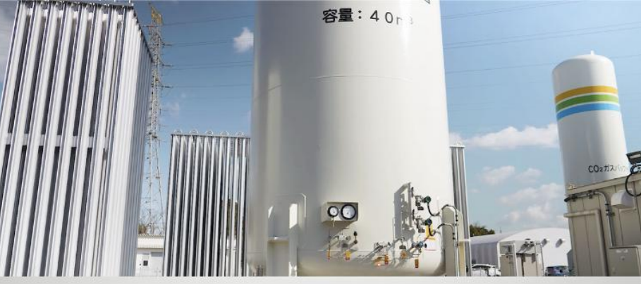
CO 2 供給設備
