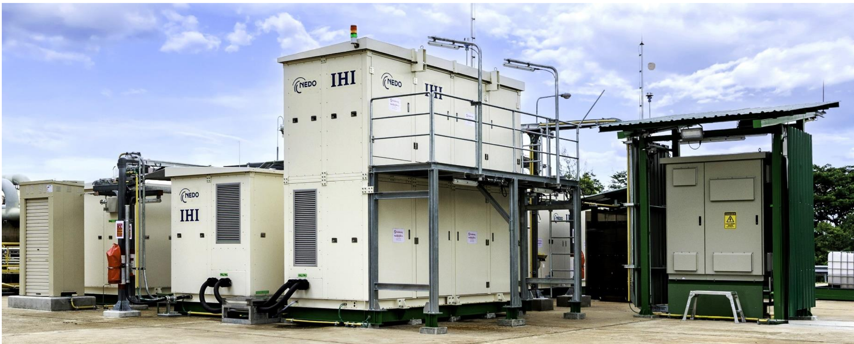
低級オレフィン合成設備（現地設置）
