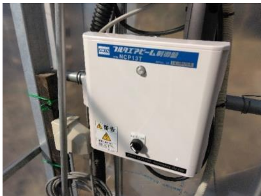
散水設備（制御盤）
