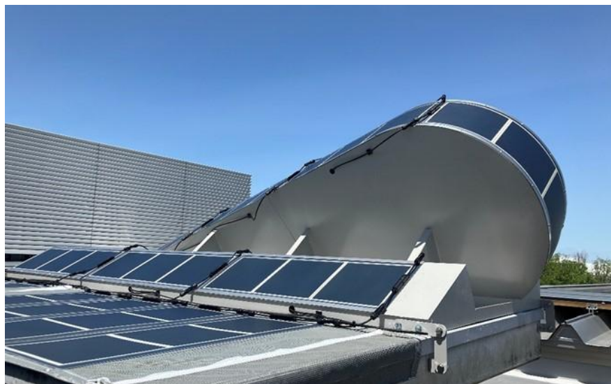
大林組技術研究所での設置状況
