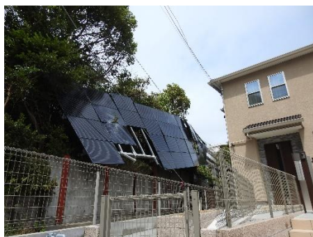
集合住宅上のPV設備が 強風で飛散・落下した事例
