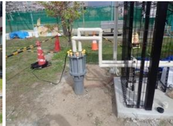
井戸管・加温装置接続部
