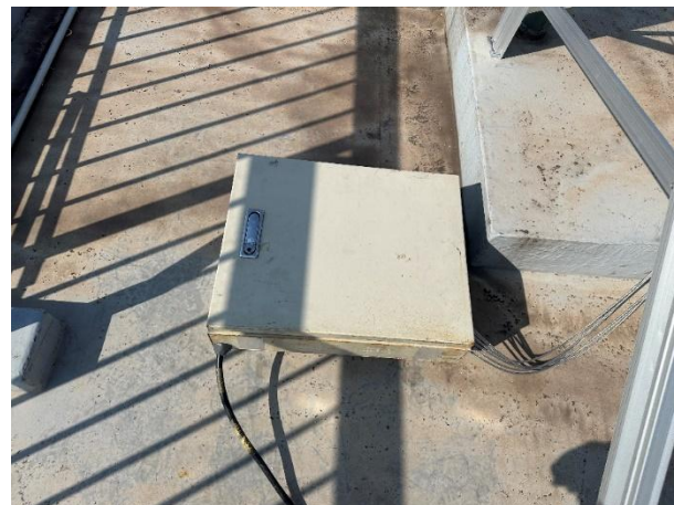
ガラス管単体性能計測盤
