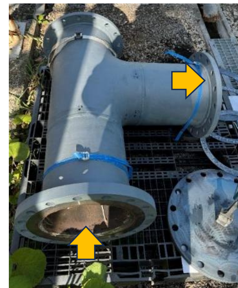
設置された坑口チーズ (T継手)
