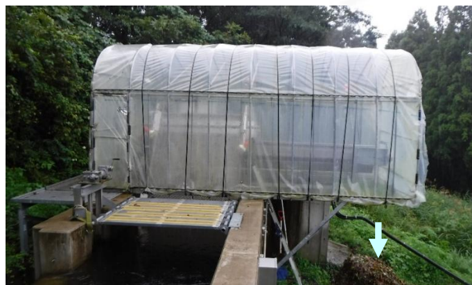
ネット式除塵機から排出された塵芥堆積の様子
