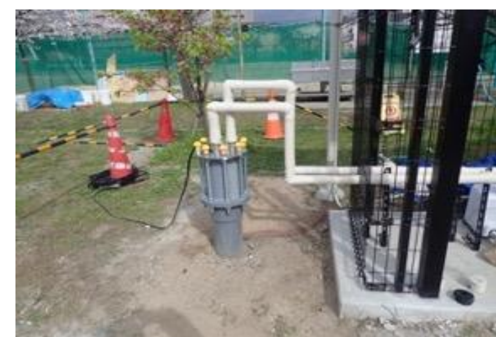
井戸管・加温装置接続部
