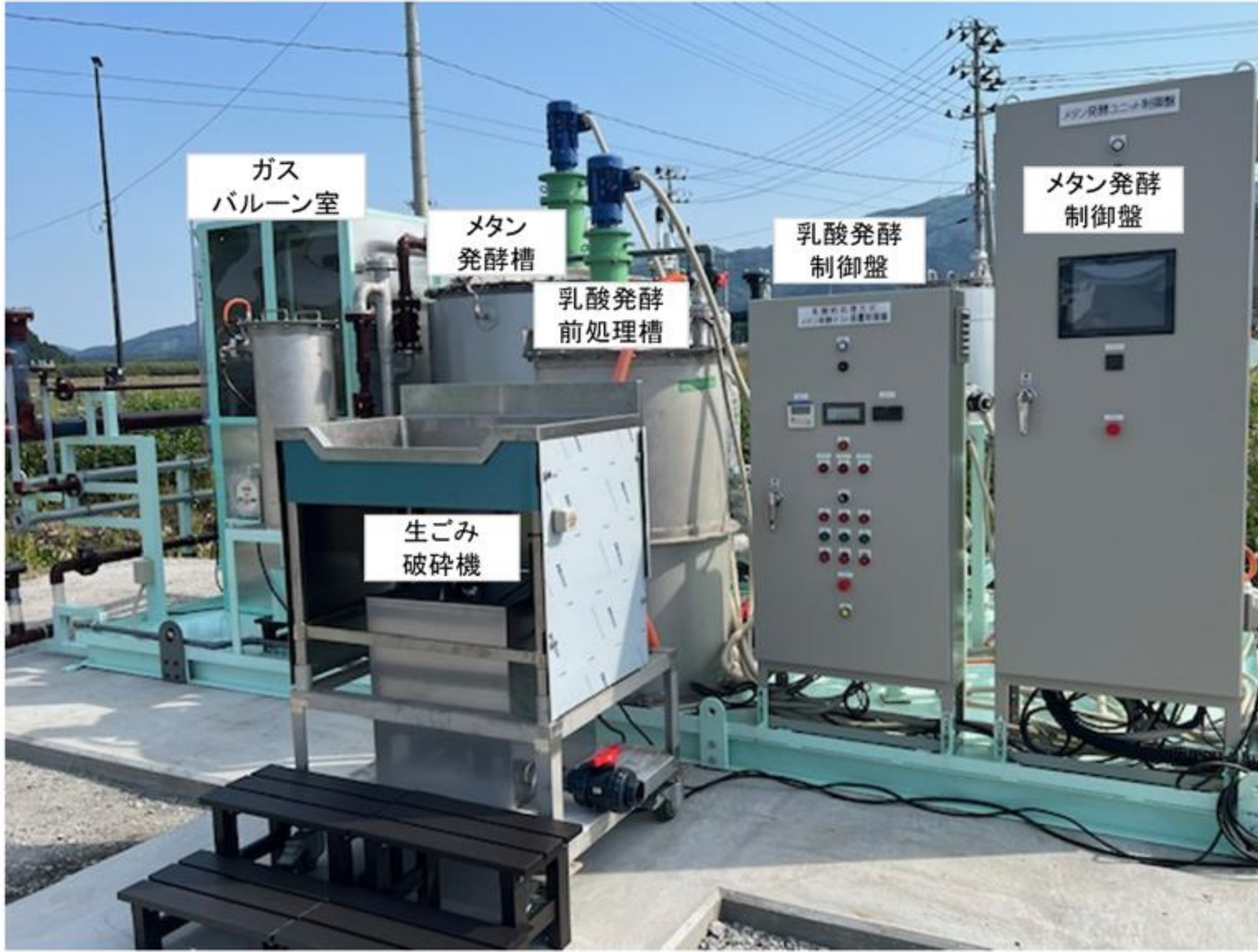
陸前高田市の導入した乳酸発酵前処理ならびにメタン発酵実証機（原料は生ごみと汚泥）
