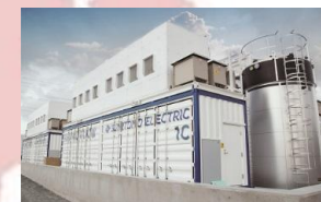
蓄電池の送電・配電併用運転実証（米国）
