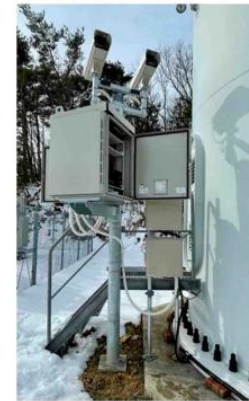
隣接風車の根元に設置
