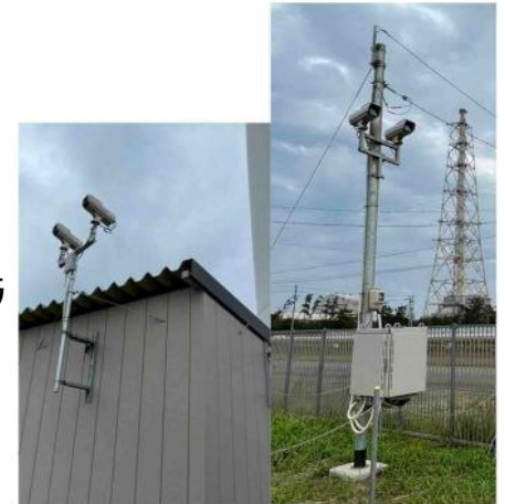
建屋に設置 独立柱に設置
