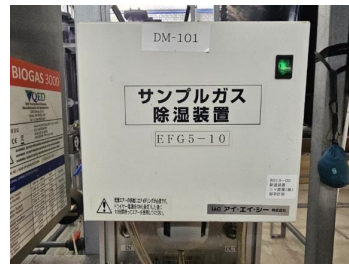
⑧バイオガス一次除湿器
