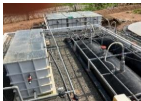
汚泥貯留槽 (左側)
