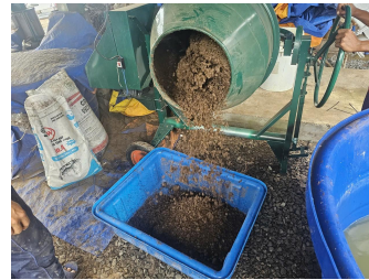
バイオマス投入
