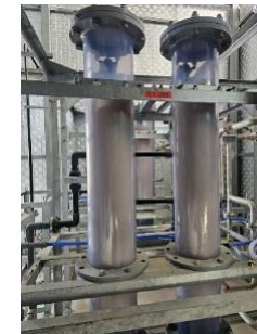
⑪バイオガス 二次脱硫塔
