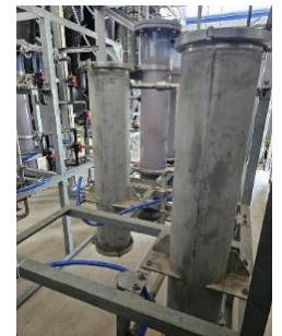
⑫バイオガス 二次除湿器
