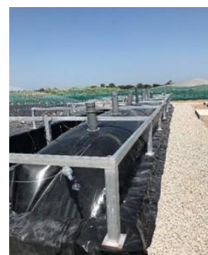
循環式ゴムチューブ発酵槽
