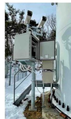
隣接風車の根元に設置
