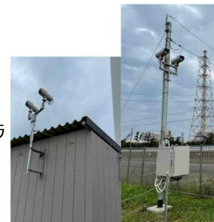
建屋に設置 独立柱に設置
