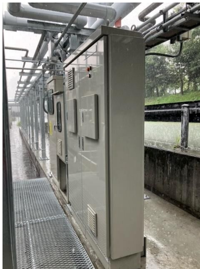
連携制御システム制御盤
