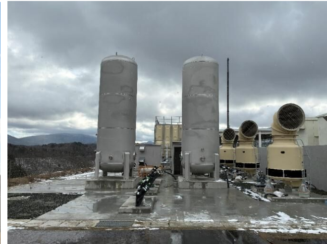
水素・酸素 低圧ガス 受入設備
