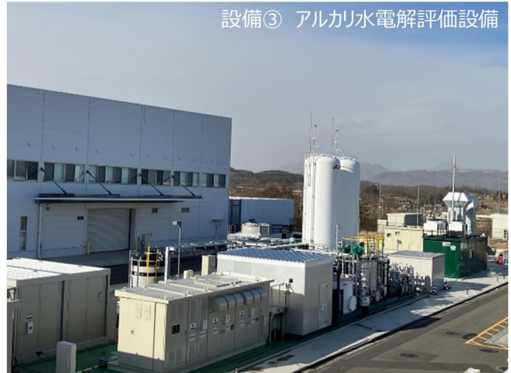
2024年度 アルカリ水電解装置設置完了
