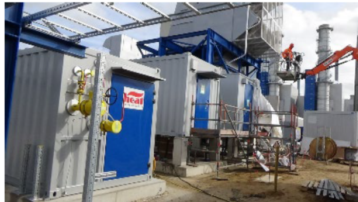
水素ガスタービン関連装置
