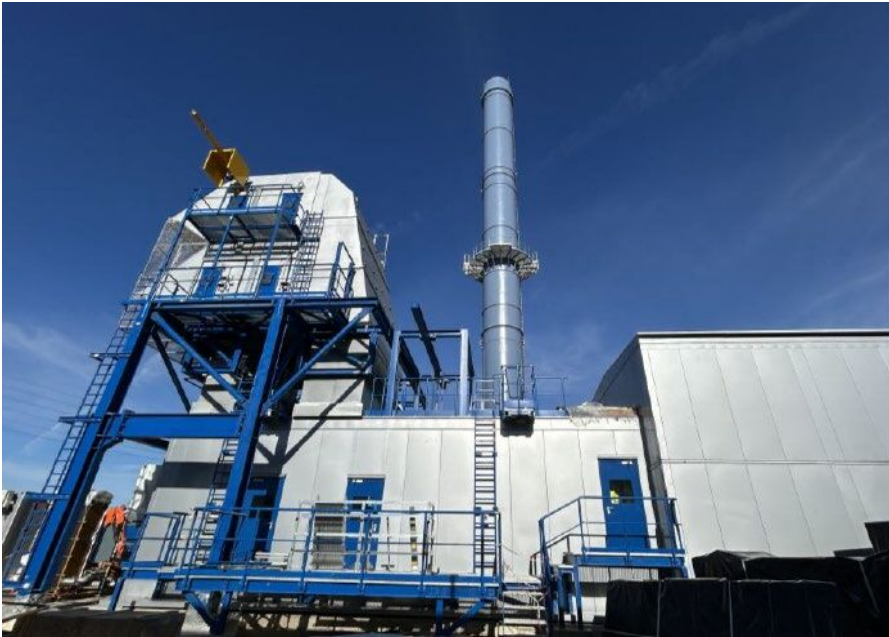
水素ガスタービン発電所
