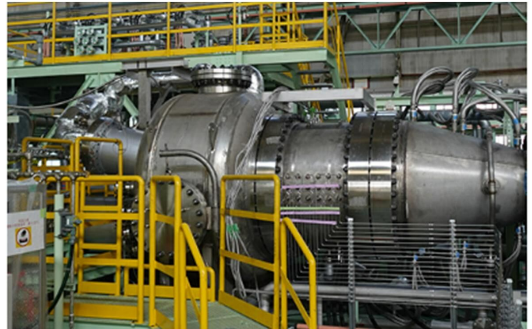
100%アンモニア燃焼試験に成功した試験設備
