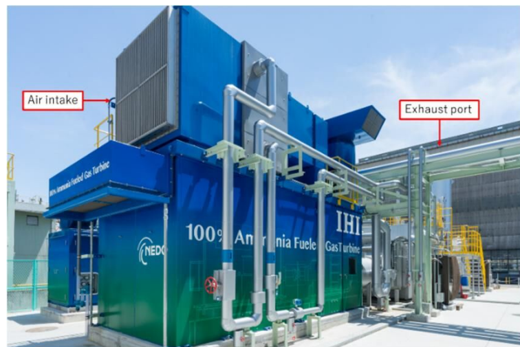
長期耐久性確認試験ガスタービンパッケージ (IHI相生事業所に設置)
