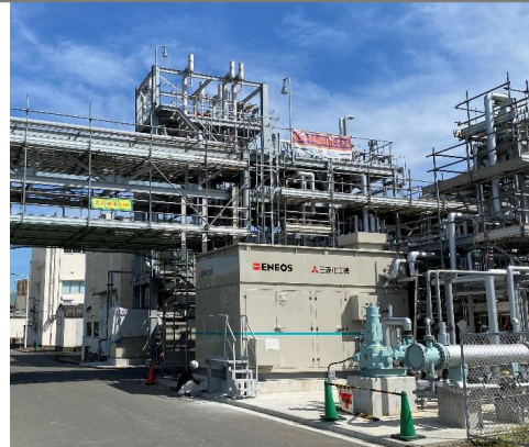
合成ガス製造 (逆シフト反応設備)
