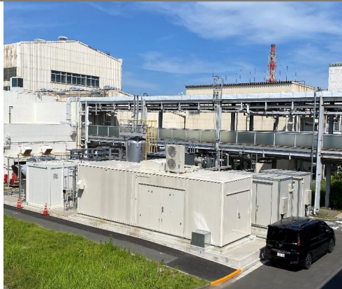
CO 2 フリー水素製造 (水電解設備)
