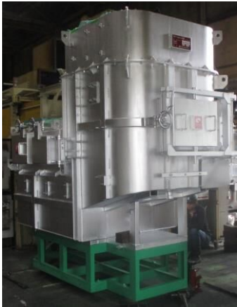
溶解炉の設置
