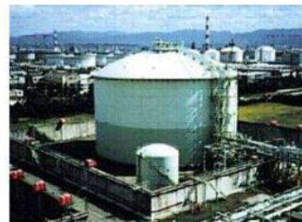
防液堤と大型平底円筒形 貯槽の例（LNG貯槽）
