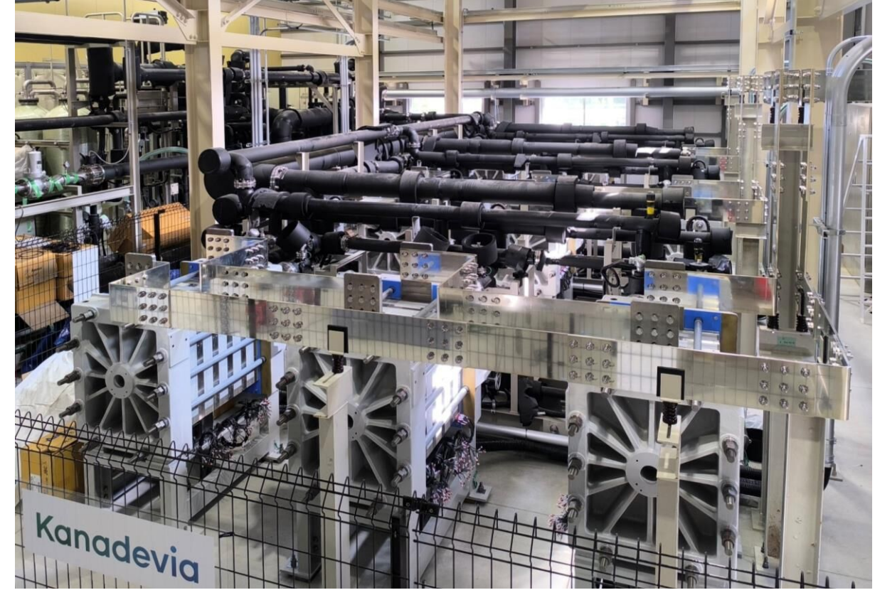
GI基金事業で開発した水素製造装置
