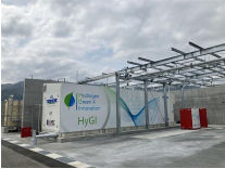
【マルチ圧力出荷設備】
