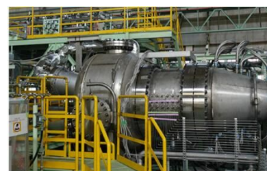
100%アンモニア燃焼試験に成功した試験設備
