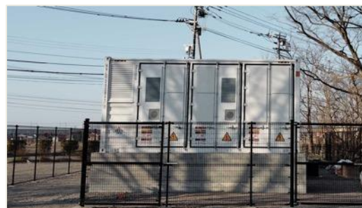
石川県 2MW / 4MWh
