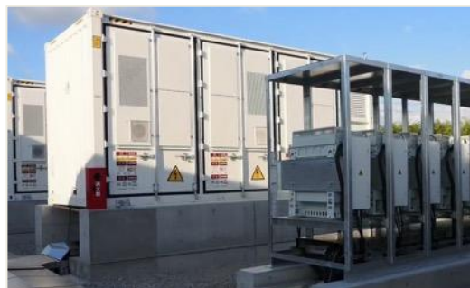
徳島県（国府） 2MW / 4MWh
