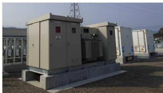
徳島県（吉野川） 2MW / 4MWh
