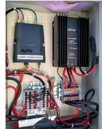
チャージコントローラー等の内部装置
