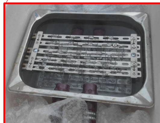
試験槽を使った試験
