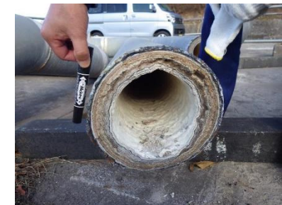
スケールが付着した 還元熱水配管
