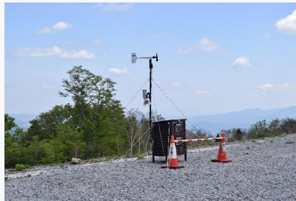
地熱発電所モニタリング
