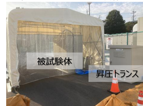
C社S-GFL・GFMインバータ設備
