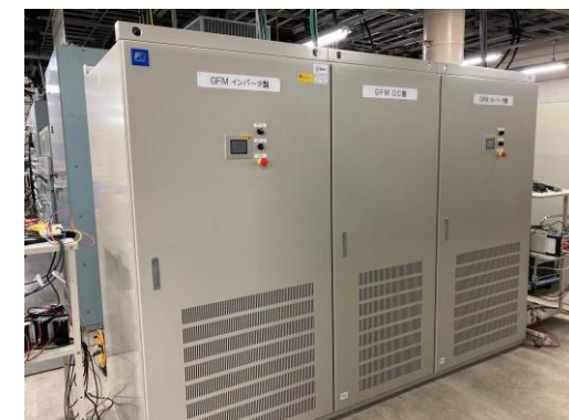
GFMインバータ実証設備
