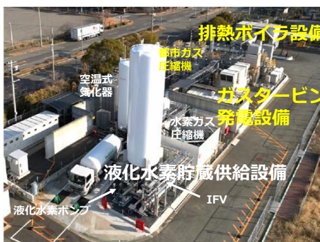
「水素CGS実証プラント」設備概要
