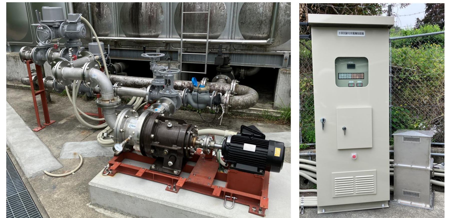
図7.フィールド試験場
