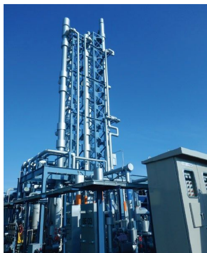
CO 2 回収実証試験設備
