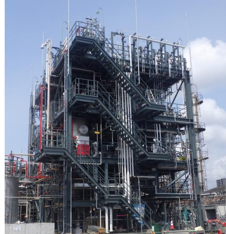
エタノールからの 高効率ブタジエン合成ベンチ設備
