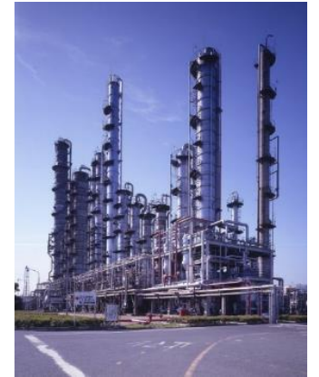
水島工場GPIプラント
