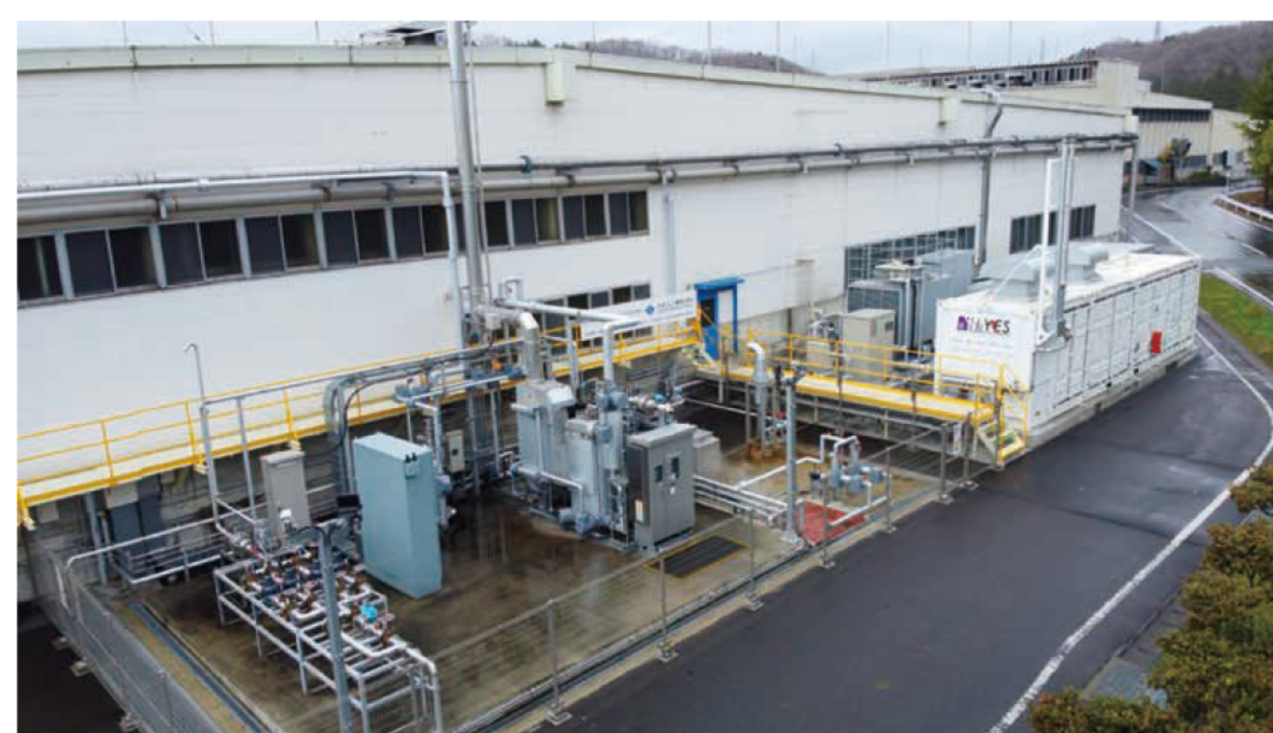
左:水素ボイラーと付帯設備 右奥:水電解装置
