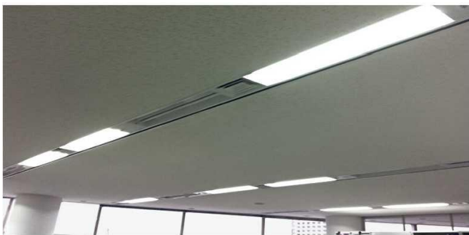
照明(LED)の間引き消灯を実施
