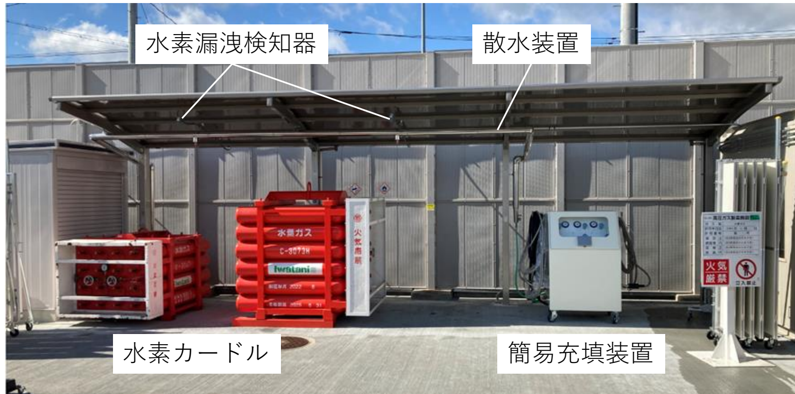
簡易水素充填設備
