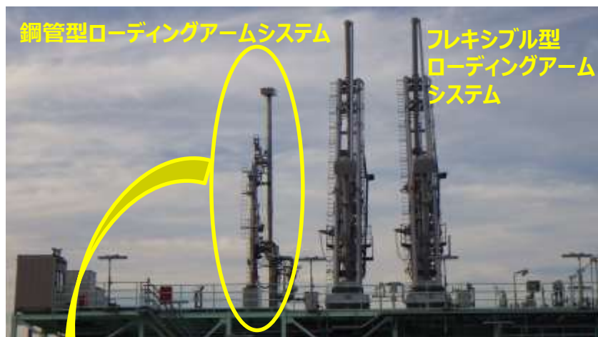
鋼管型ローディングアームシステム設置状況
