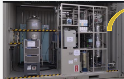
高圧水電解装置 50kW 最大75V、最大5000A
