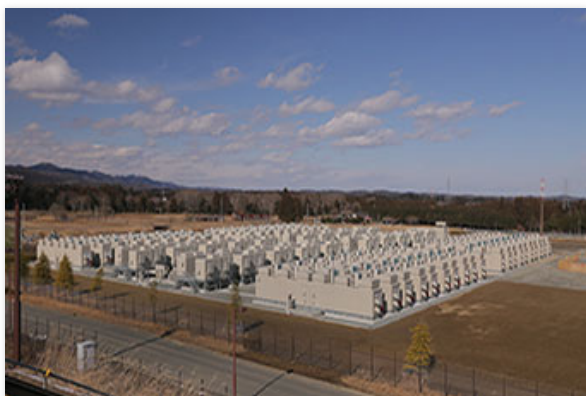
写真1 「23Ahセル」が搭載された蓄電池システムが納入された東北電力株式会社南相馬変電所（写真提供：東芝インフラシステムズ）
